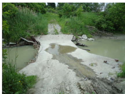
Ponceau non conforme
