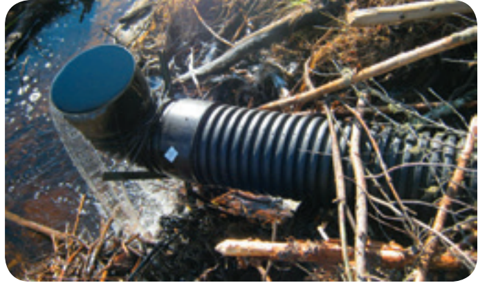
Figure 40 : Le contrôle de décharge
